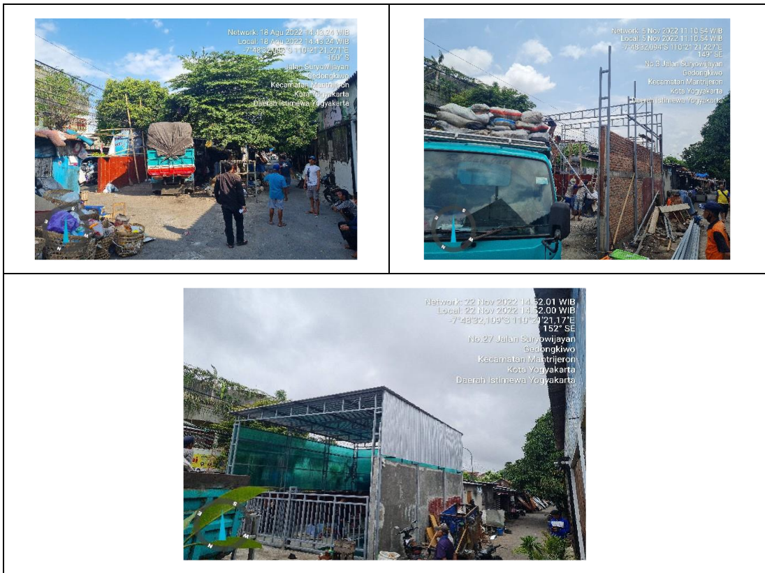
Gambar 3. 19 Kegiatan Pelaksanaan Pekerjaan Rehabilitasi Depo/TPS Suryowijayan
